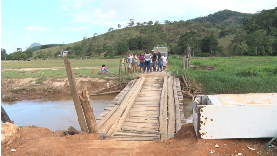
Figura 60 - Na imagem alguns moradores da comunidade reclamam da queda da ponte, cabe ressaltar que nesta imagem a ponte já tinha passado por uma intervenção paliativa. Fonte: Retirado de uma reportagem da Tv Guarapari, 2022. Disponível em: https://www.youtube.com/watch?v=ZFFZyjVtsOU . Acesso em: 10 jul. 2023.
