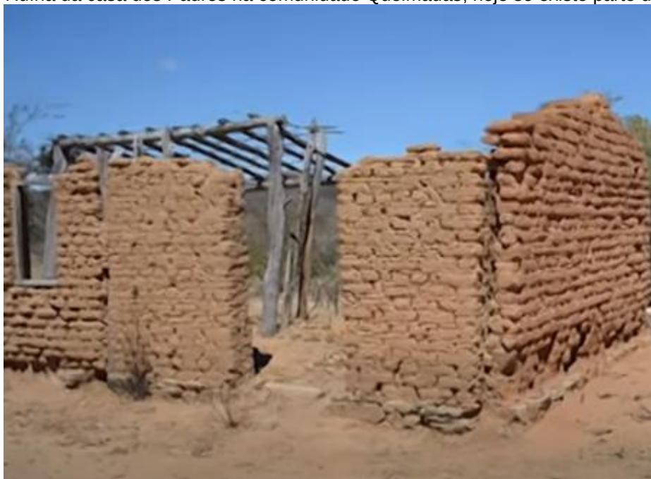
Figura 38 - Ruína da casa dos Padres na comunidade Queimadas, hoje só existe parte dos alicerces.
