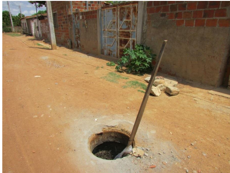
Figura 8 - Poço de visita aberto no bairro João Paulo II.
