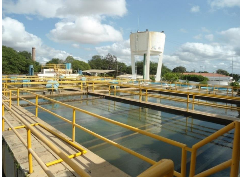
Figura 3 - Estação de Tratamento de água.
