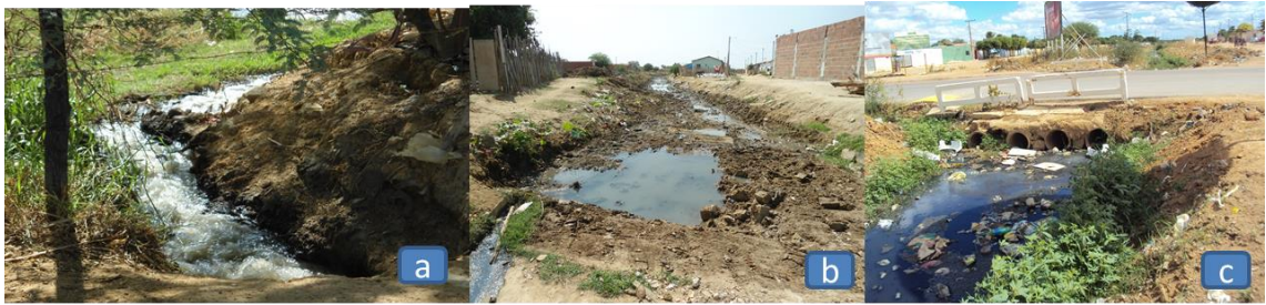
Figura 16 - Interconexão de esgoto em canal de água pluvial nos bairros: (a) Dom José Rodrigues; (b) Codevasf; (c) João Paulo II.
