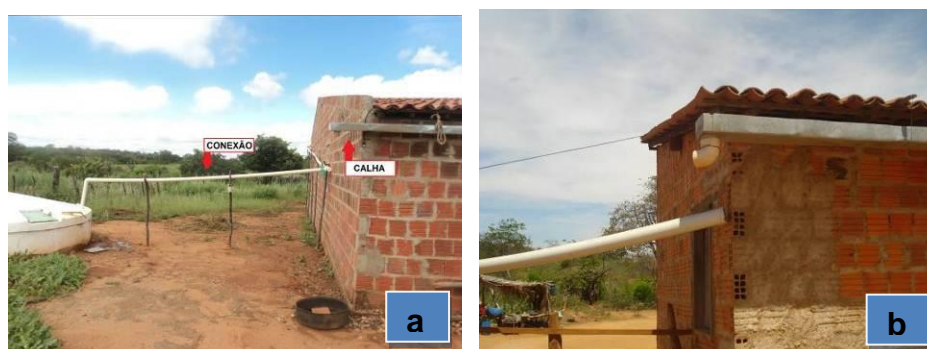
Figura 27 - (a-b) Conexões e calhas nos telhados das residências que captam água de chuva
