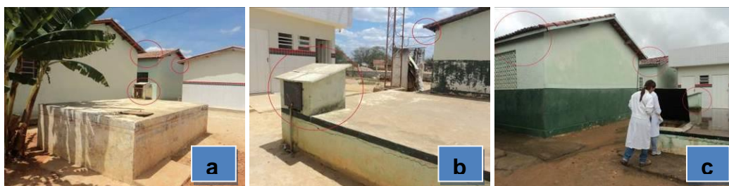
Figura 30 - (a-b-c) estrutura do telhado sem calhas e bombas elétricas nas cisternas escolares
