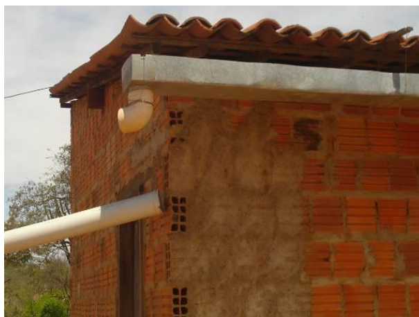
Figura 6 - Calha para aparar água do telhado
