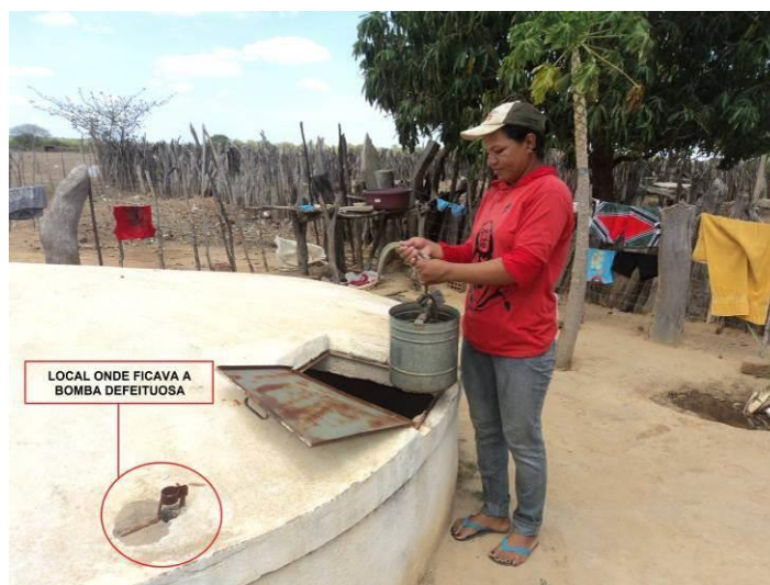
Figura 38 - Retirada manual de água, devido defeito em bomba
