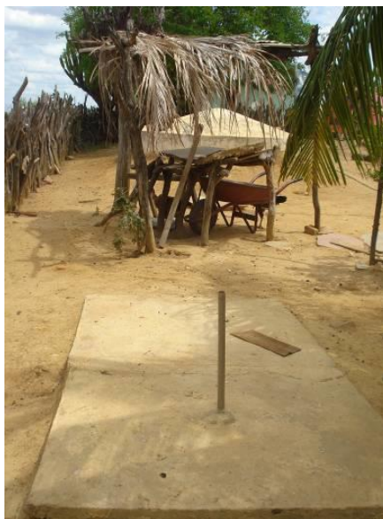
Figura 35 - Fossa séptica próxima à cisterna domiciliar na localidade de Cristália
