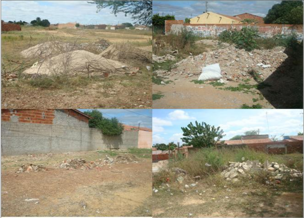
Figura 13: Disposição inadequada de resíduos sólidos provenientes da construção civil no bairro Pedra do Lorde.
