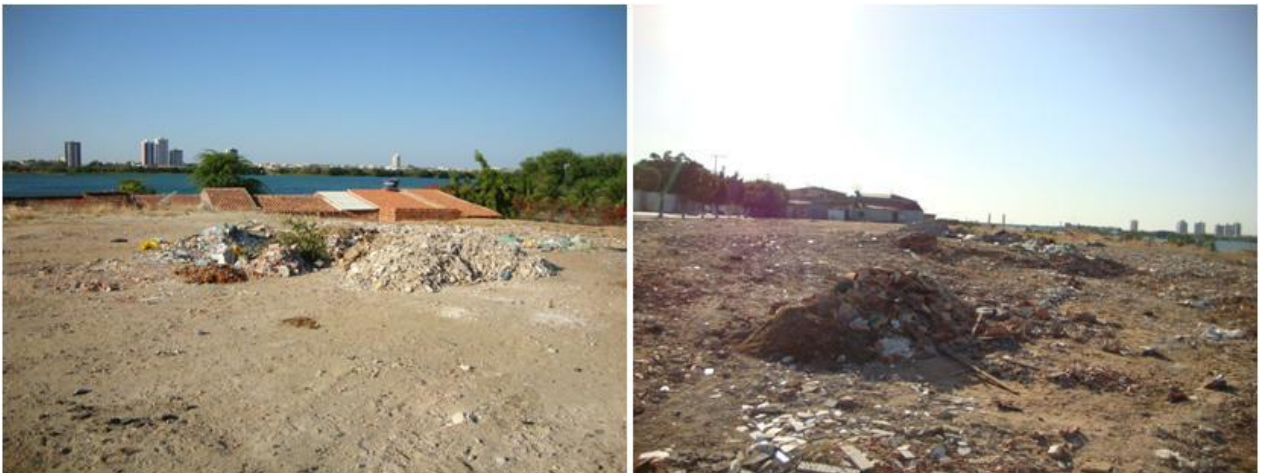
Figura 10: Disposição inadequada de resíduos sólidos provenientes da construção civil no bairro Angari.
