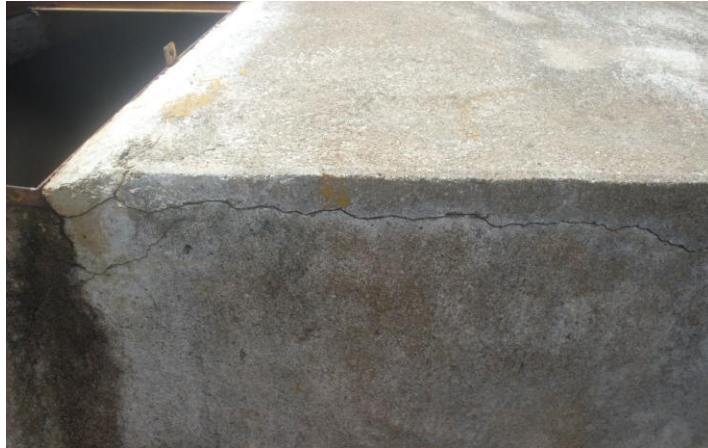
Figura 30: Rachadura em cisterna na localidade de Lagedo – PE.
