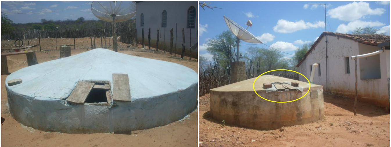
Figura 31: Estado de conservação das tampas de cisternas na localidade de Lagedo - PE.
