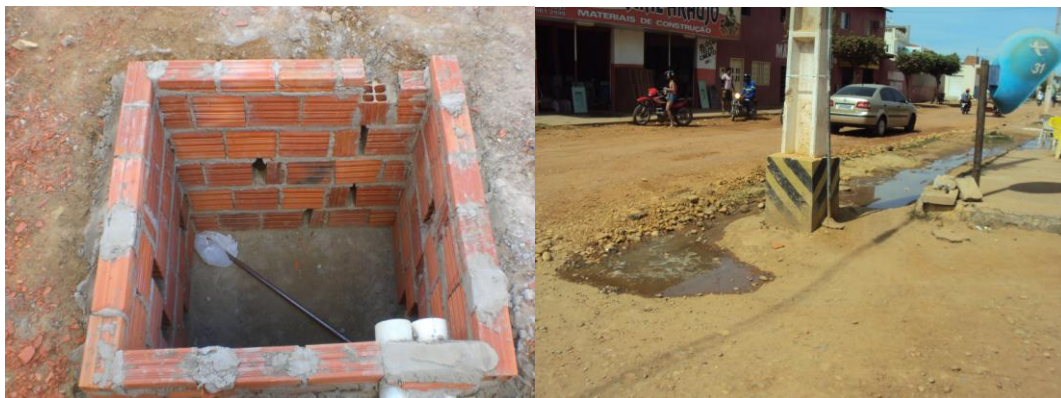
Figura 09: (a) construção de caixa de inspeção. (b) Escoamento de esgoto a céu aberto.
