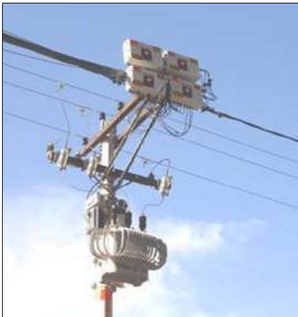
Figura 2.3- Sistema de medição centralizada instalado na área de concessão da Ampla (Ampla, 2008).
